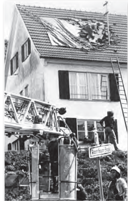
Unzählige Dächer wurden beschädigt und mussten neu eingedeckt werden
