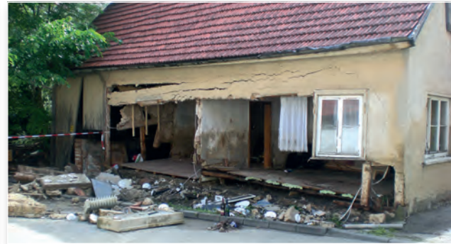
Teile der Hauswand wurden mitgerissen
