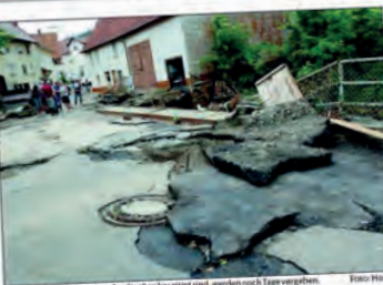
Die größten Schäden an den Straßen liegen hier, werden noch Tage weggehen. Foto: Hopp
